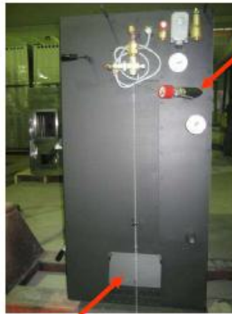
a) Feuerungsregler (schließt Verbrennungszuluft komplett bei 90°C)
